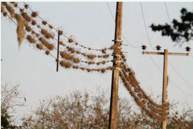
Figura 5: Plantas Tillandsia recurvata creciendo sobre el tendido eléctrico (Tamaulipas, México).
